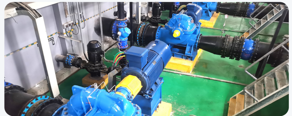
改造后循环水泵
