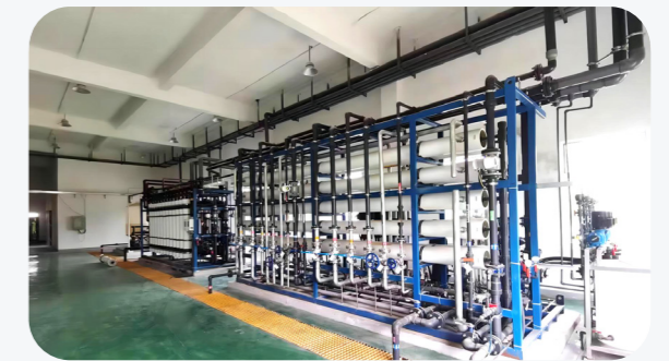
膜系统现场图片
