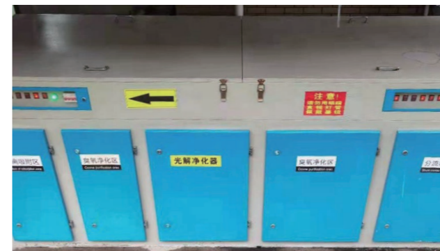
■ 废气处理设施
