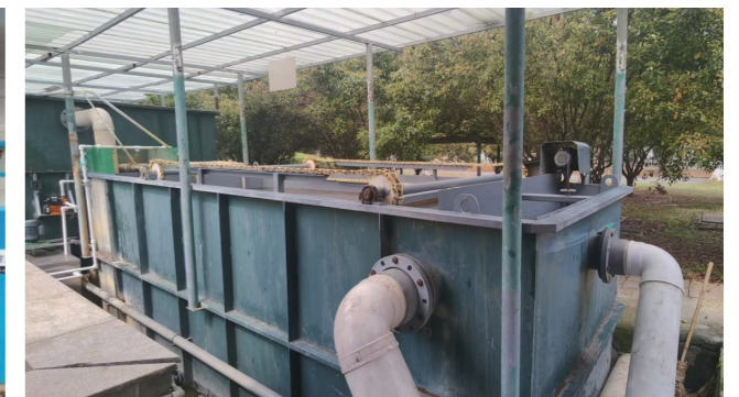
■ 废水处理设施
