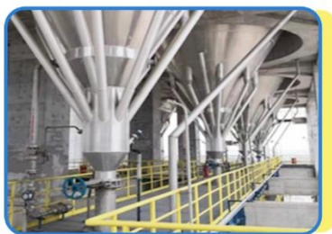
掺混料仓锥体及掺混室
