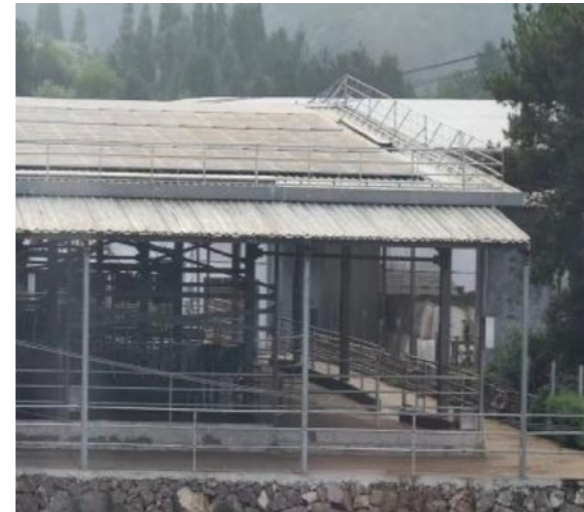
泰顺牛舍光伏发电设施
