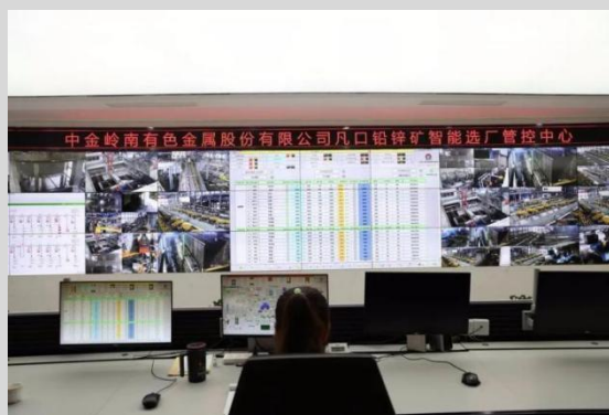
凡口矿智能选矿厂管控中心
