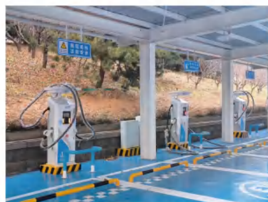
· 泰山石油充电站项目
