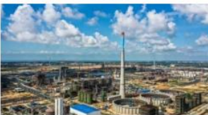
中科(广东)炼化一体化项目
