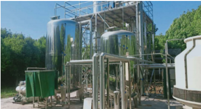
乙醇回收再利用项目
