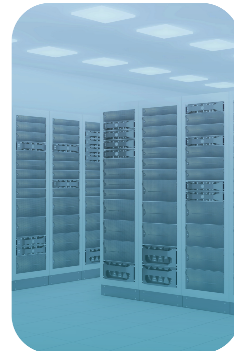
ICT基础设施
