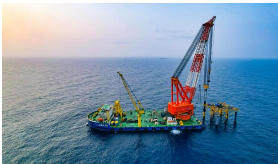
图 4 亨通广东明阳阳江青洲四海上风电项目
