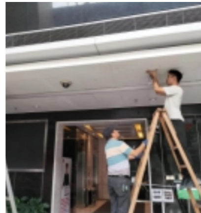
监控设备升级改造
