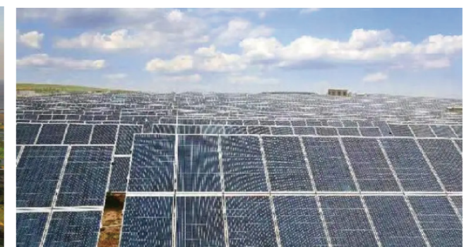
光伏发电厂项目
