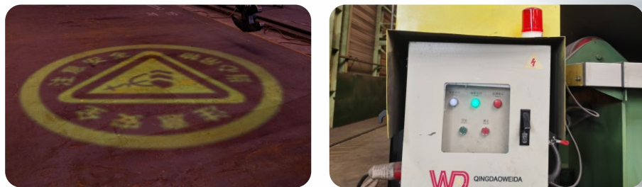
起重机安全投影灯、滚轮机架运转报警器以及吊车运营指示灯
