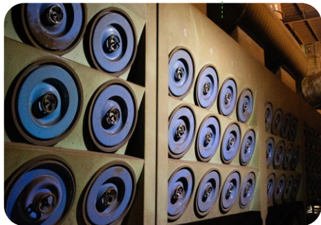
布袋收集装置与废气综合处理装置
