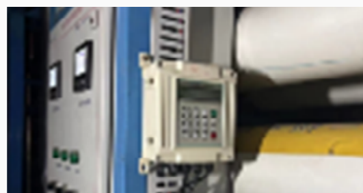
Retrofitted Condensate Piping
