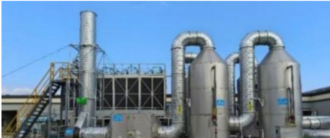
废气处理设施
