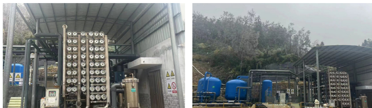
▲ 高氨氮尾水膜处理系统
