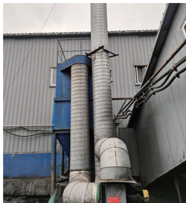
▲ 东于煤业布袋除尘器
