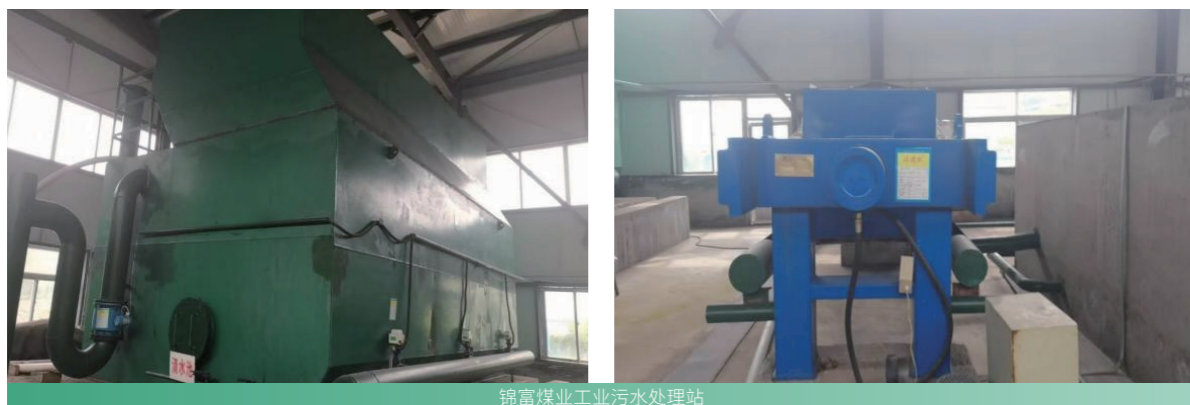
锦富煤业工业污水处理站
