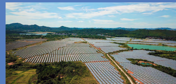
江西景德镇乐平 65MW 地面光伏发电项目
