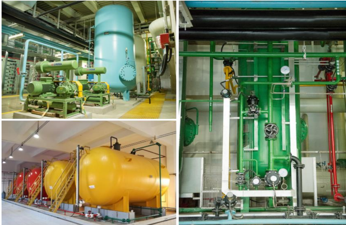
凝结水精处理系统设备实物图
