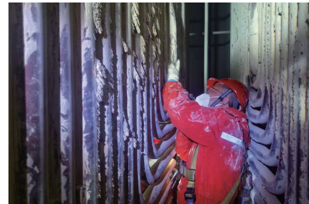
工作人员检查锅炉受热面改造情况
