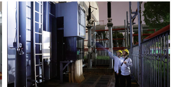
浙能金燃巡检人员在深夜检查主变运行情况
