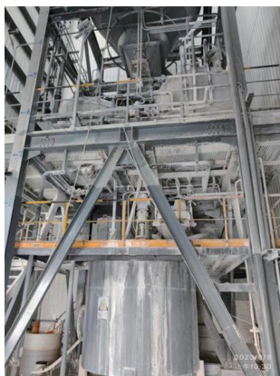
石灰浆制备系统
