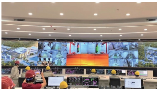
垃圾焚烧发电厂中控室
