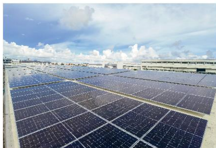
中航通飞航空产业基地光伏屋面
