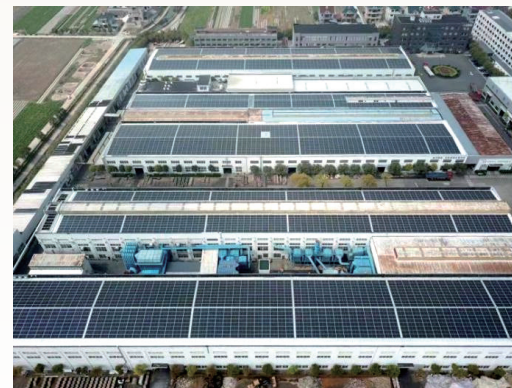
(1.7MWp屋顶式光伏项目)
