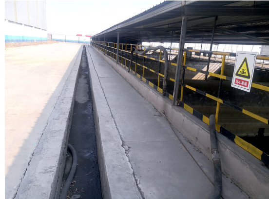
Rainwater collection and utilisation facilities 雨水收集利用設施
