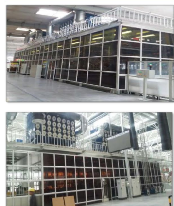
长城汽车整车厂自动焊接 工作间烟气治理
