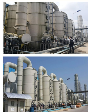
泰国天合光能1.2GW 太阳能电池生产线废气治理
