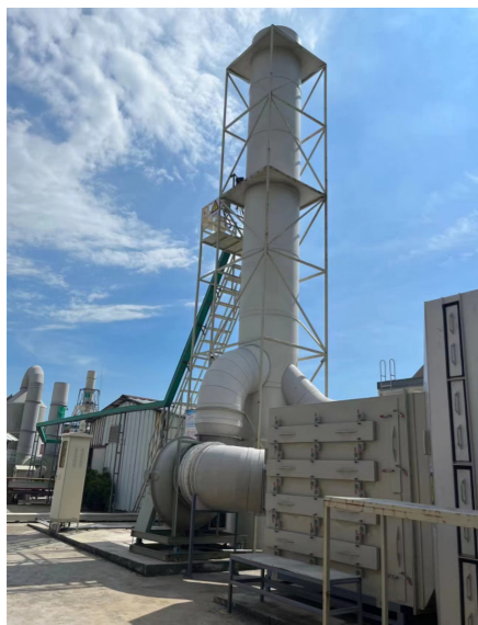
改造后的有机废气处理系统
