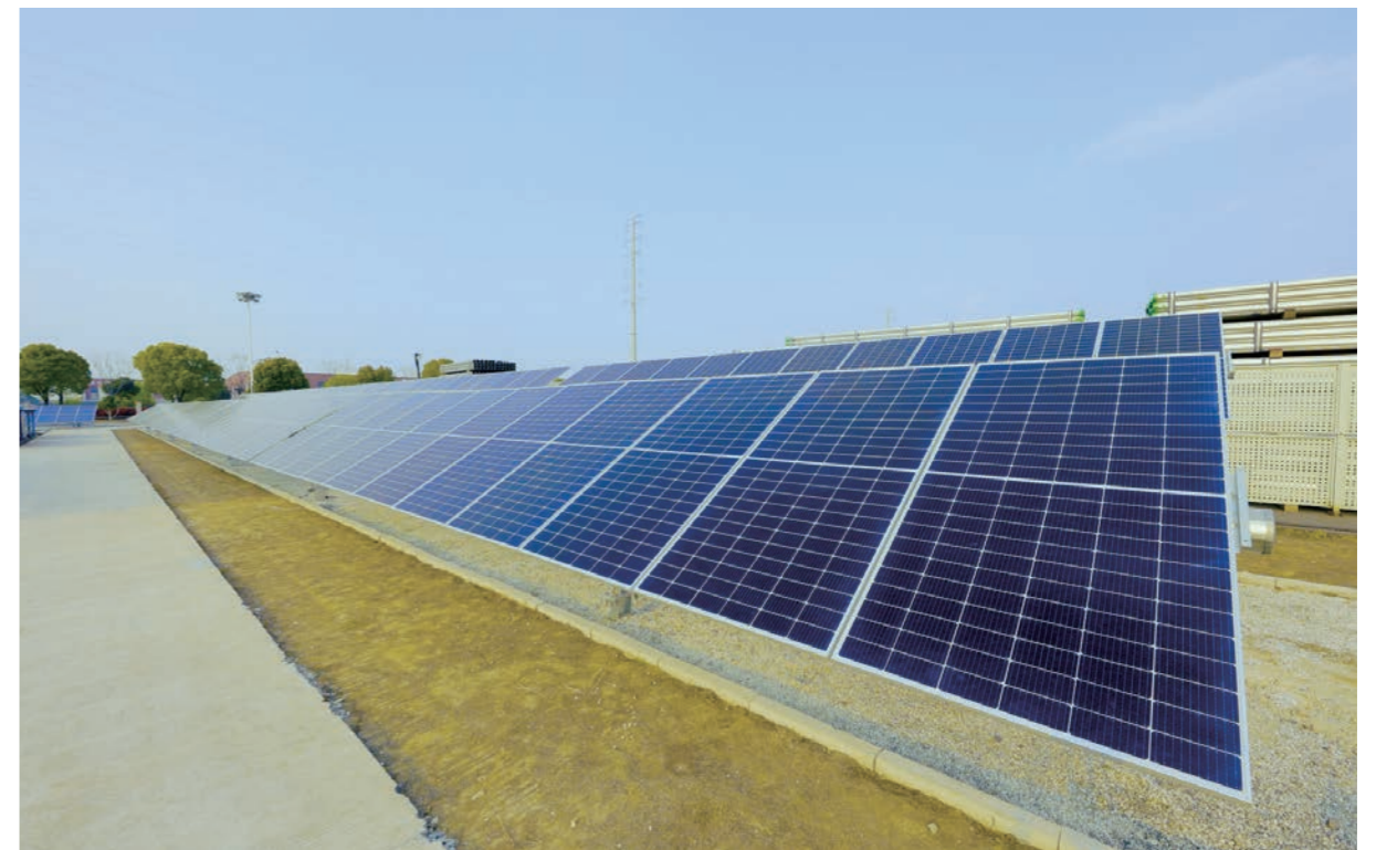
常州光伏示范基地
