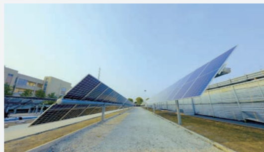
常州光伏示范基地
