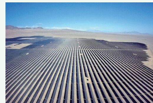
大柴旦100万千瓦光伏项目
