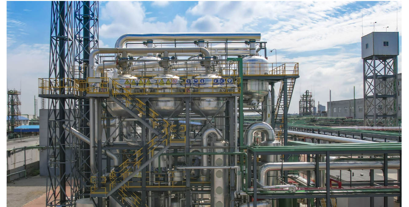
图：VOCs 废气治理系统
