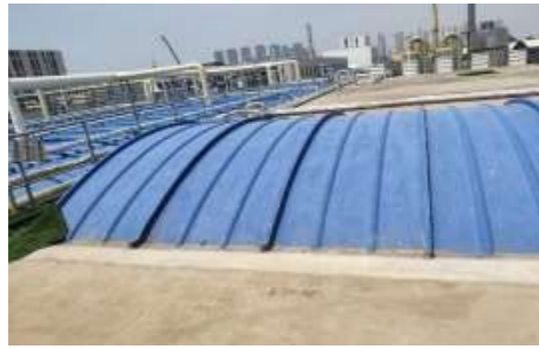
图：污水处理设备
