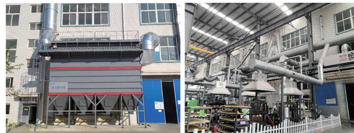
山东昊方联合铸造有限公司铸造废气处理设备
