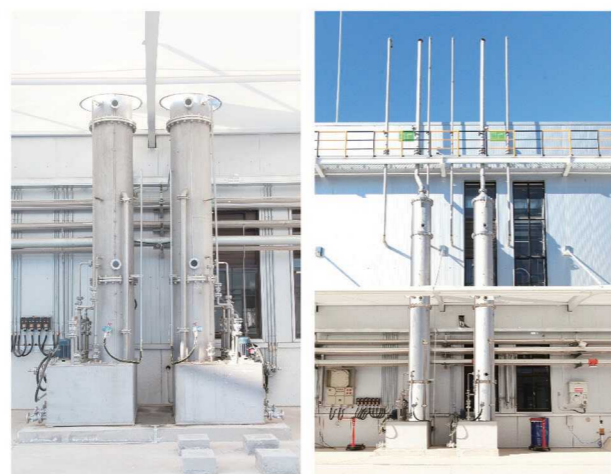
“万海舟”加氢废气处理装置
