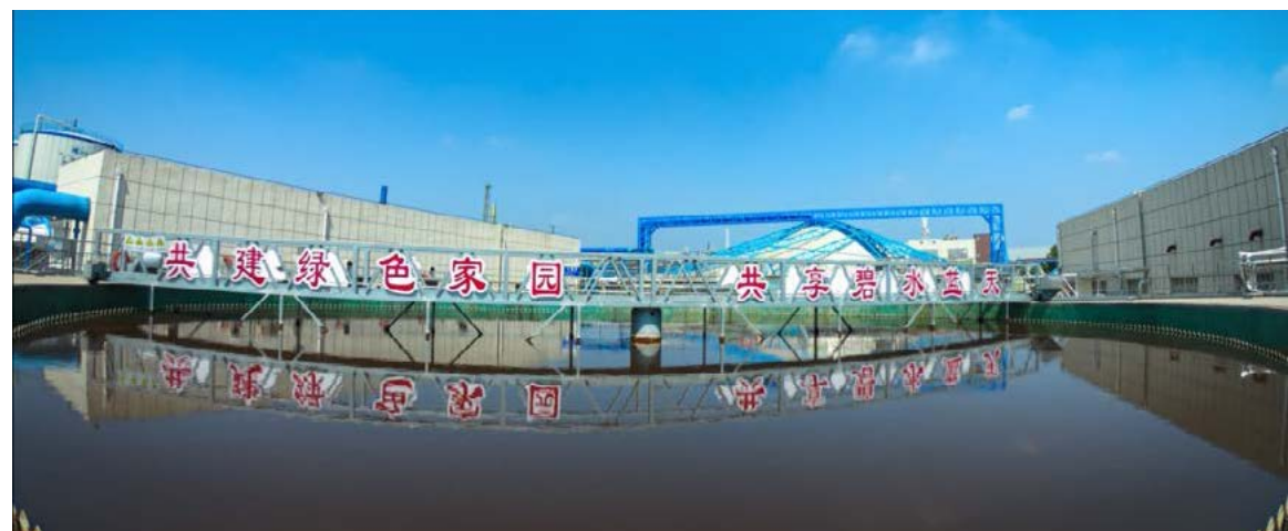
鲁抗医药环保污水处理设施
