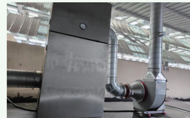
废气除尘装置
