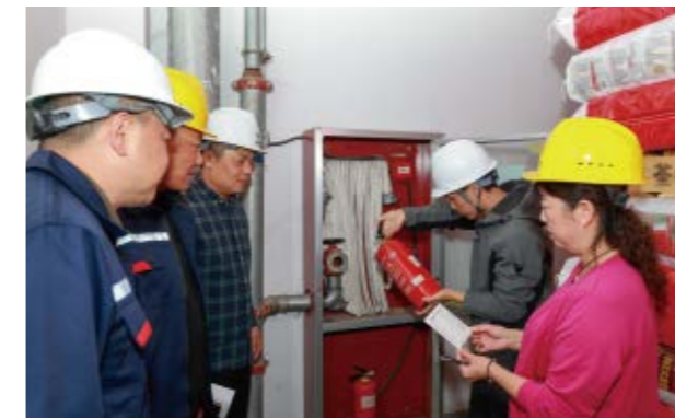
消防日检查消防器材
