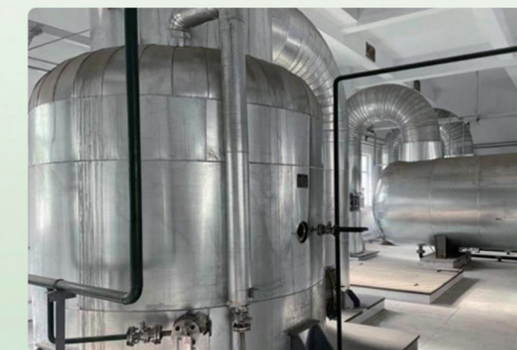
同华发电脱硫废水零排放项目（三效闪蒸系统）
