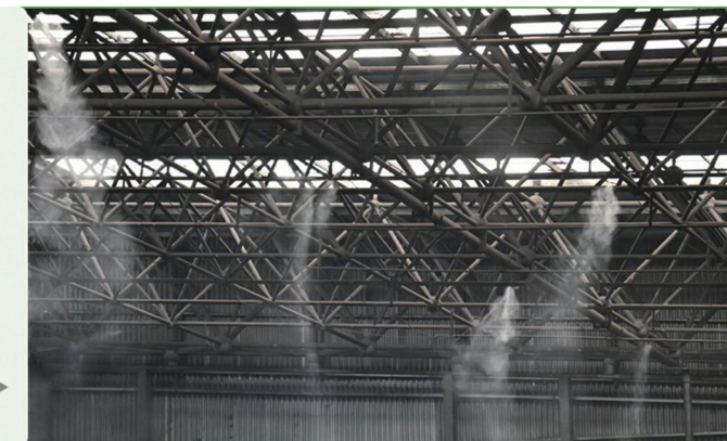
临汾热电公司封闭煤场内喷雾抑尘装置启动 ▶
