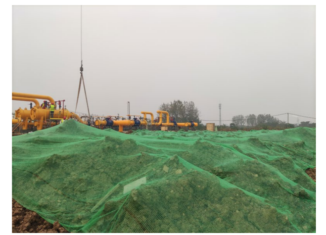
站场绿网覆盖
