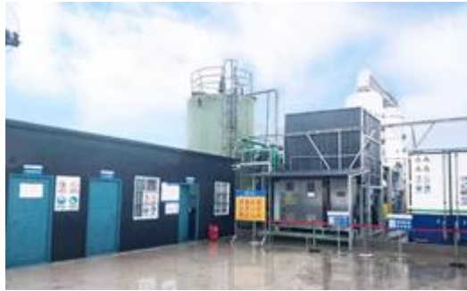
湖北洪湖渗滤液全量化处理项目
