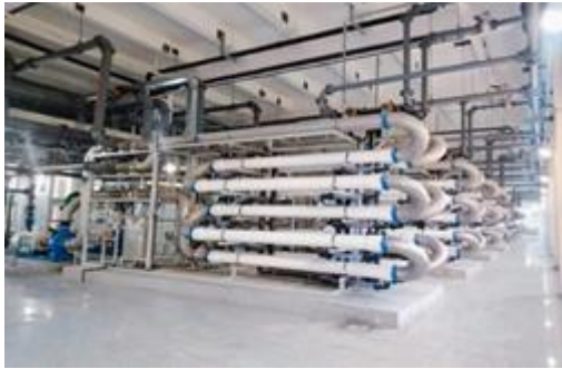
华电集团邹县电厂软化除硬项目
