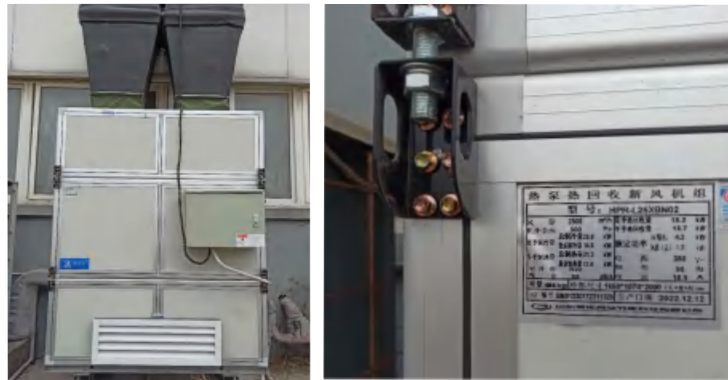
热泵热回收新风机组
