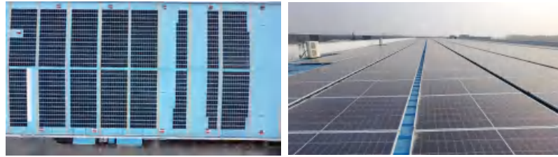
光伏发电系统
