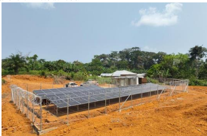
图：喀麦隆微电网项目现场
