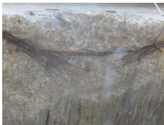
图 4-6-3 板底刮蹭破损
