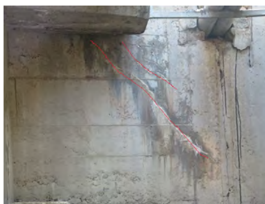
图 4-6-7 桥台竖向裂缝
