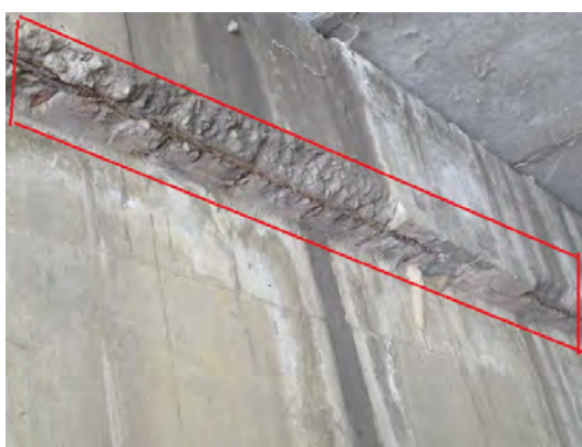
图 4-6-6 桥台锈胀露筋
