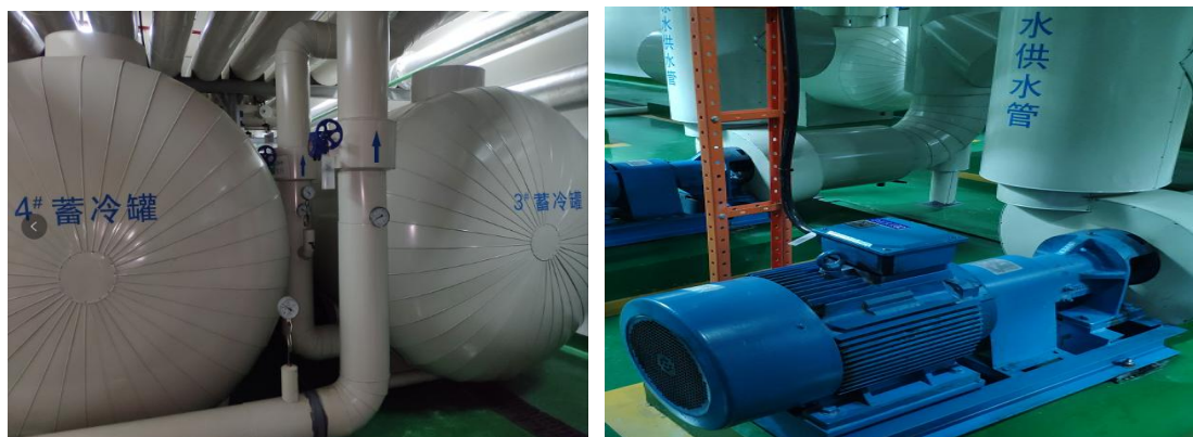
数据处理中心机房高效节能系统
