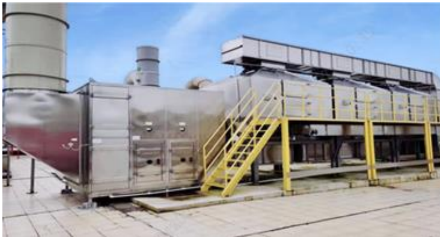
水喷淋+活性炭吸附/脱附催化燃烧设备
