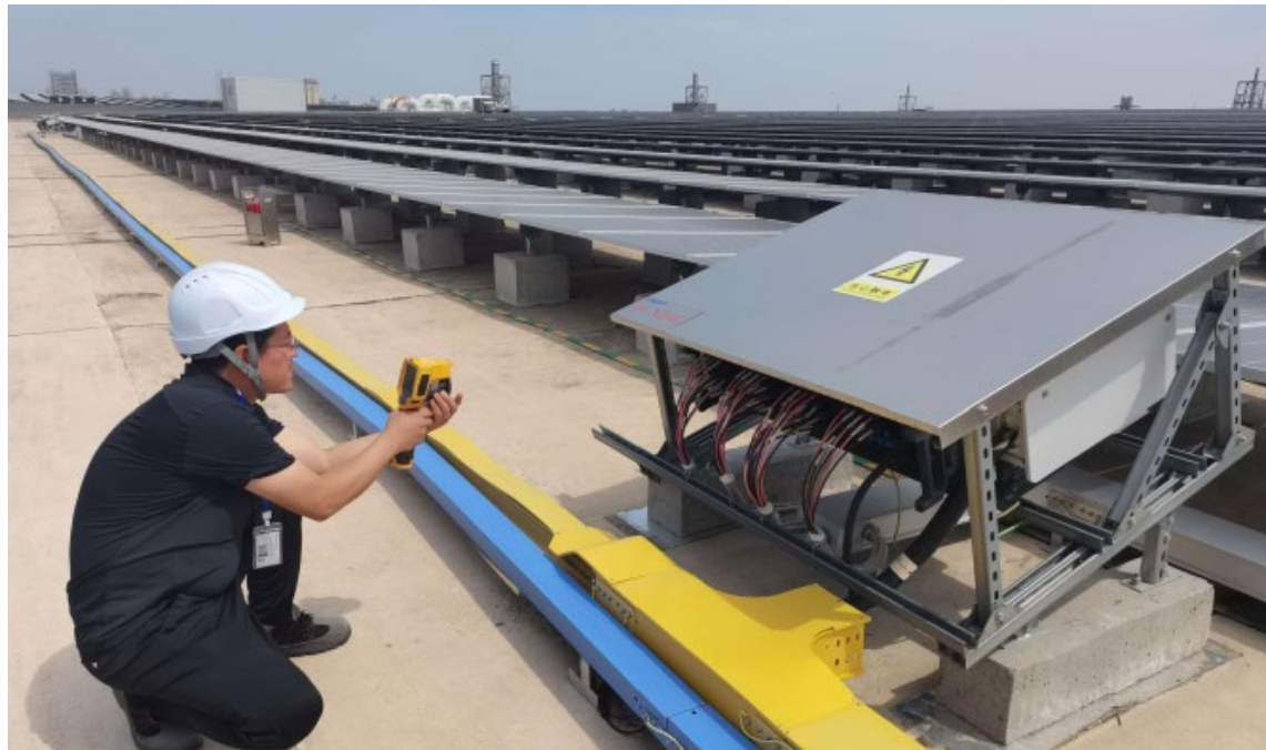
维信诺固安工厂屋顶光伏项目二期建成并网
