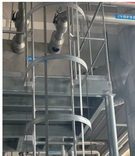
锅炉烟气余热回收
