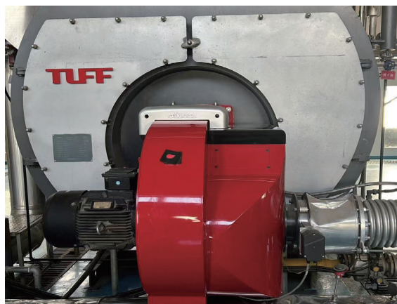
锅炉低氮改造
