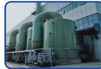
冷凝+氧化洗涤吸收塔+碱吸收塔+水洗塔
