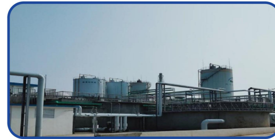
污水处理设施
