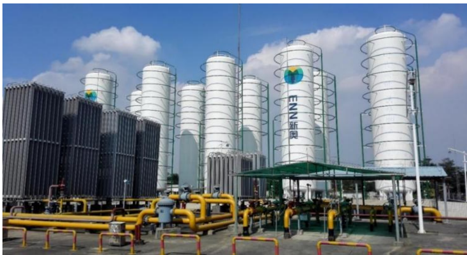
公司天然气厂站
