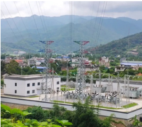
110 千伏路花输变电工程（一期）
