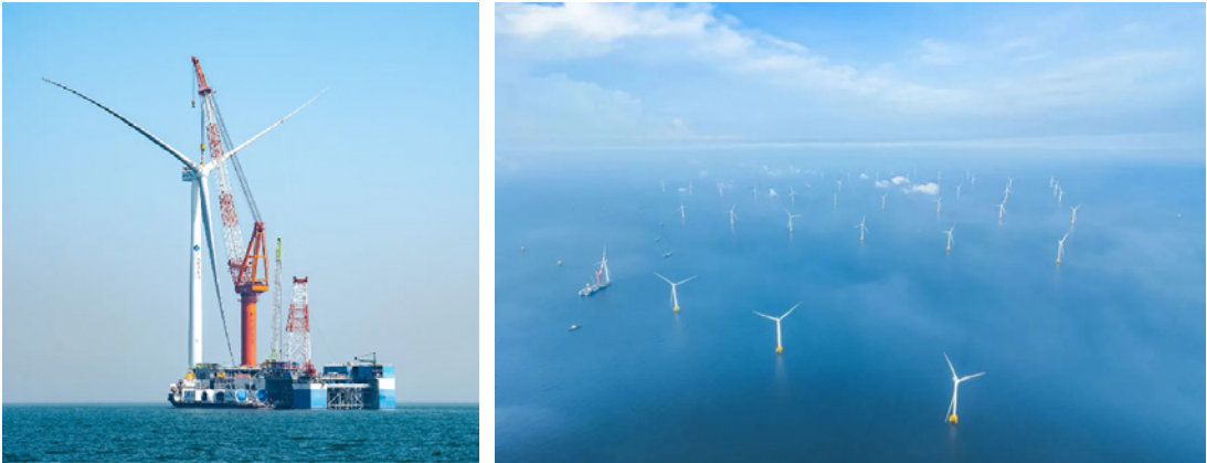
防城港海上风电示范项目
