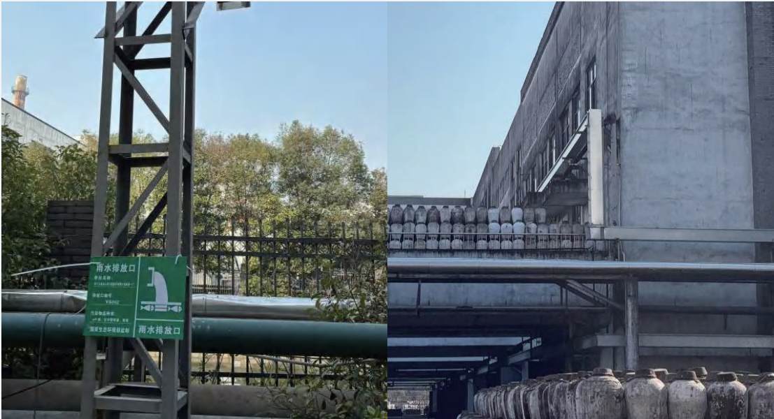
雨水不落地项目设备
