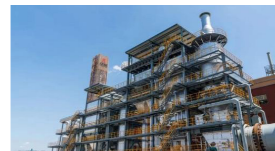
上海天马固体废物处置项目焚烧生产线
