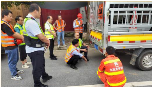
施工车辆未设置防卷入装置
