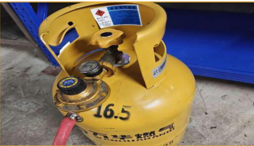
液化石油气软管长度应不大于 2 米
