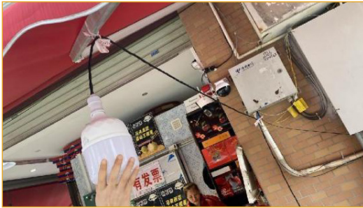
售卖棚照明灯直接绑在铁架上
