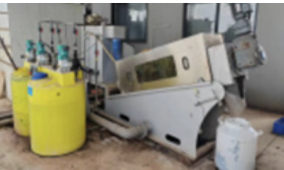
污泥压滤处理设备
