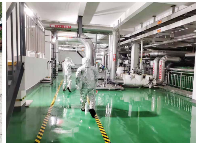
御临公司蒸汽泄漏应急演练
